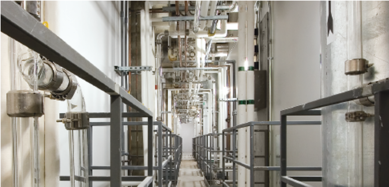
➤ Trémies où se font les raccordements de gaz et d'eau pour les laboratoires
